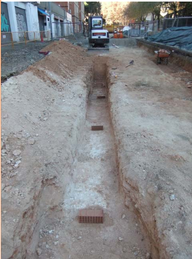
Foto 42. Rasa 10 del segon col·lector.
